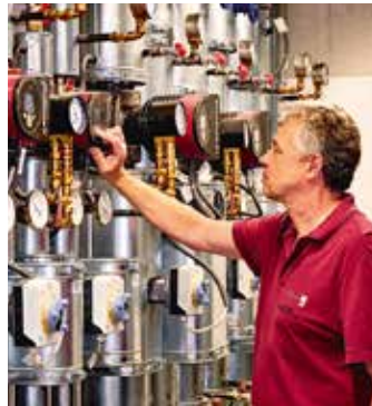
Energieeffizienz bei der Bewirtschaftung der Gebäude ist ein wichtiger Bestandteil des Nachhaltigkeits-Engagements.
